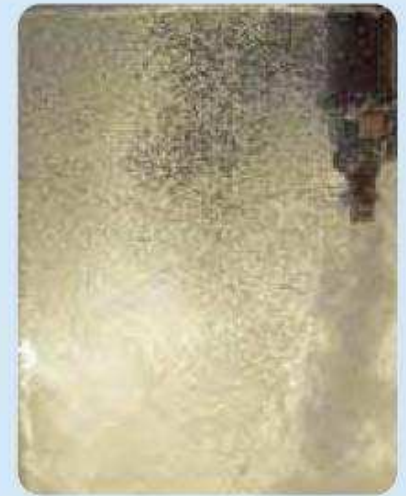
Luft eintrag mit dem Tauchmotorbelüfter und hohe Turbulenz in der SBR - Kammer
